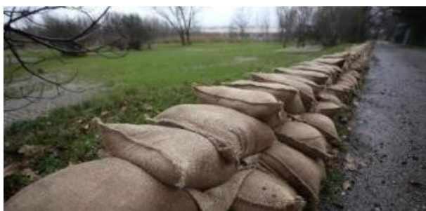
Barriera temporanea antiesondazione in sacchi di sabbia
