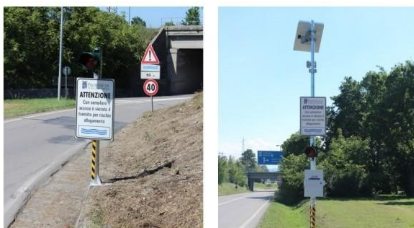
Segnaletica e pannelli a messaggio variabile.
