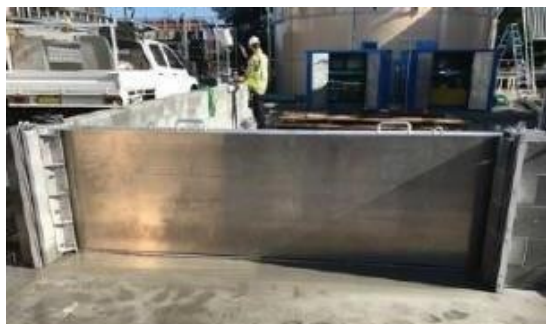
Paratoia di chiusura a scorrimento orizzontale per un cancello a tenuta idraulica
